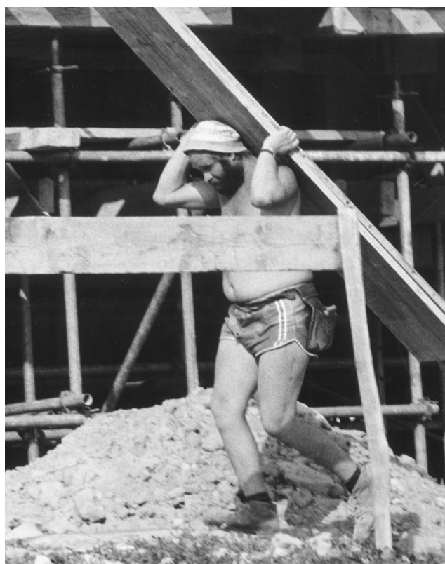
Figura 93.1 • Trabajador portando una carga sin ropa ni equipo de trabajo adecuados.
