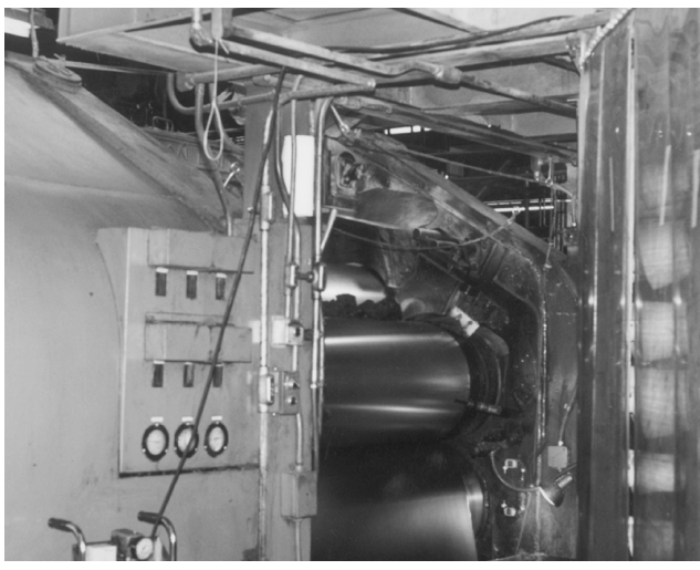
Figura 80.6 • Laminador y secador con campana de aspiración y cables de seguridad.
